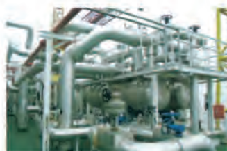
▲ 工业冷热水输送管道
